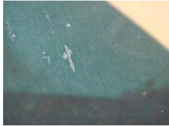
Fig. 78. Detalle del «deterioro» de un cristal Mirogard®
